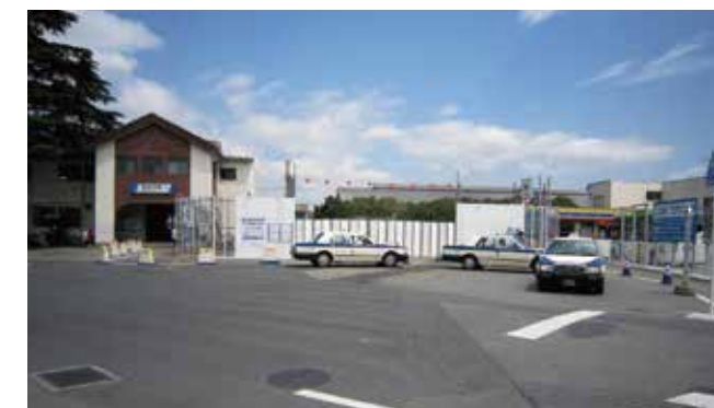
④野田市駅では、高架橋を建設するために駅舎やホーム等が支障するため、現施設を撤去、移設します。
